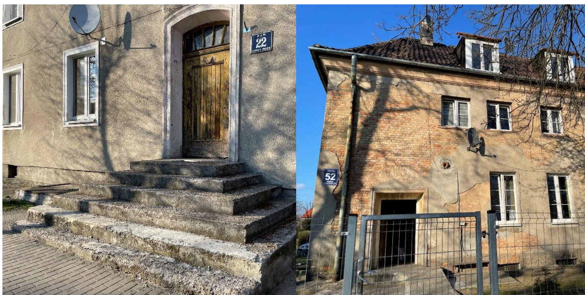
Zdjęcia 1 Stan budynków na osiedlu Bloki
