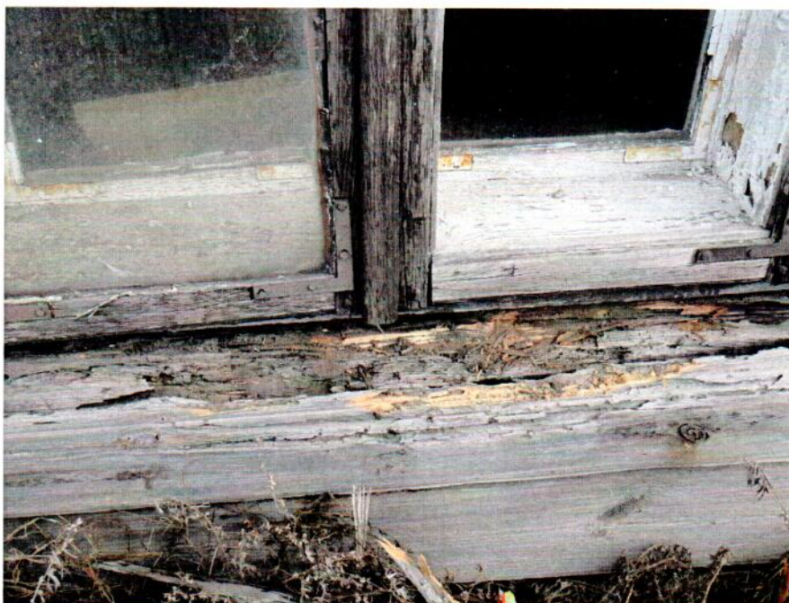
8. Spróchnienia ściany zewnętrznej elewacji północno zachodniej.
