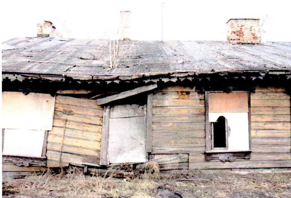
4. Detal uszkodzenia (spróchniałe bale ściany utrzymują się tylko na deskach oszalowania) (na dachu widać drzewo rosnące w zbutwiałym drewnie brzozy)
