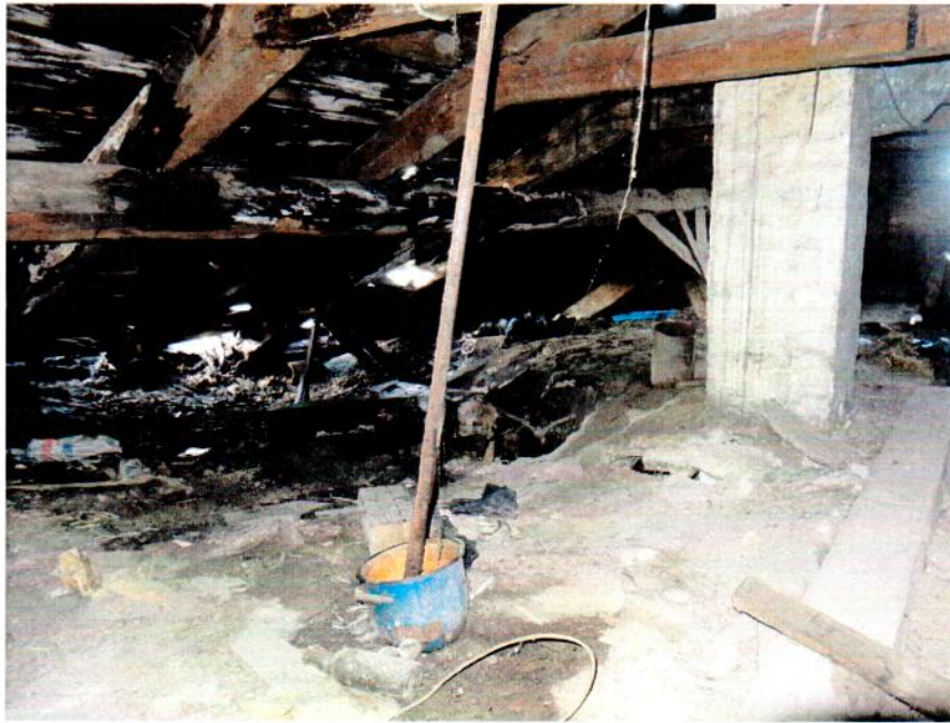
29. całkowicie zniszczony fragment więźby dachowej
