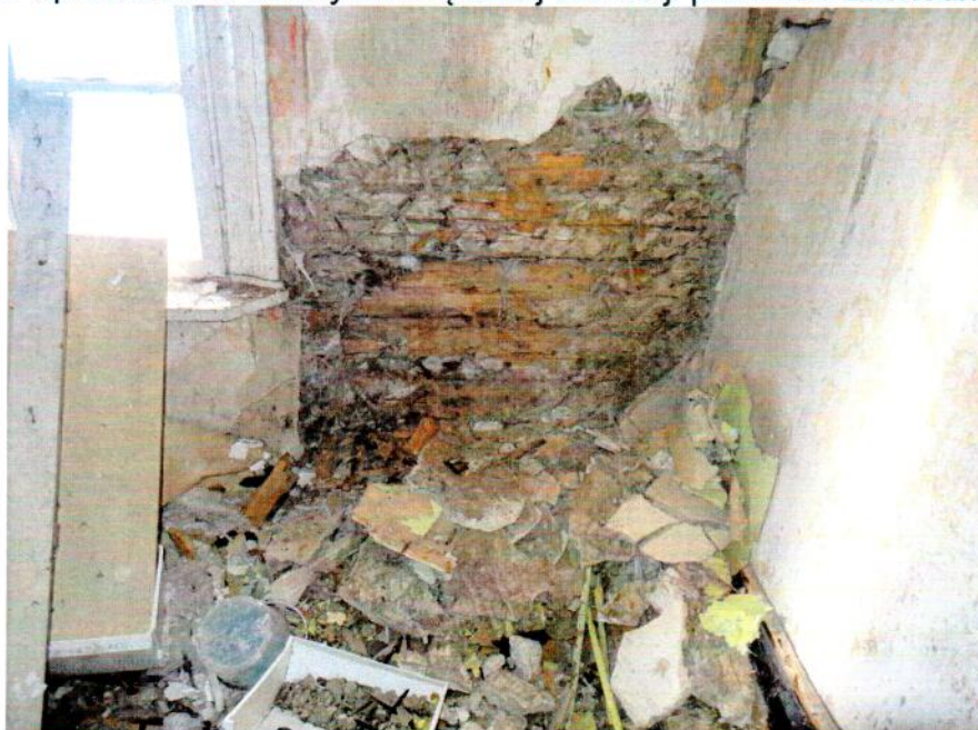
9. Ściana zewnętrzna cała powierzchnia bali porażona korozją biologiczną (ściana zachodnia).
