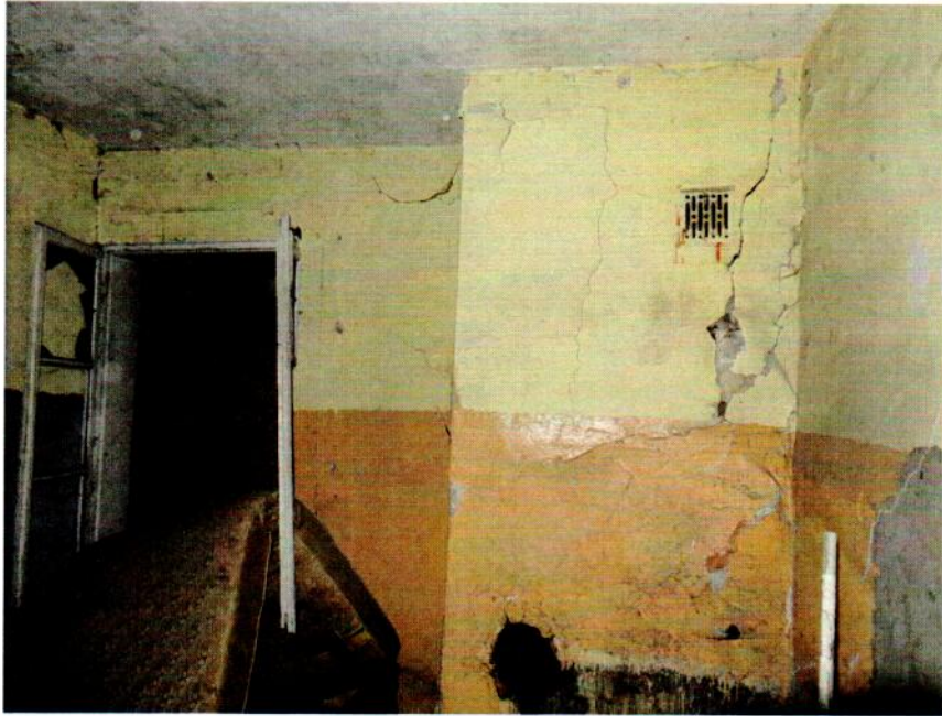
19. Stan ścian działowych, tynków i komina
