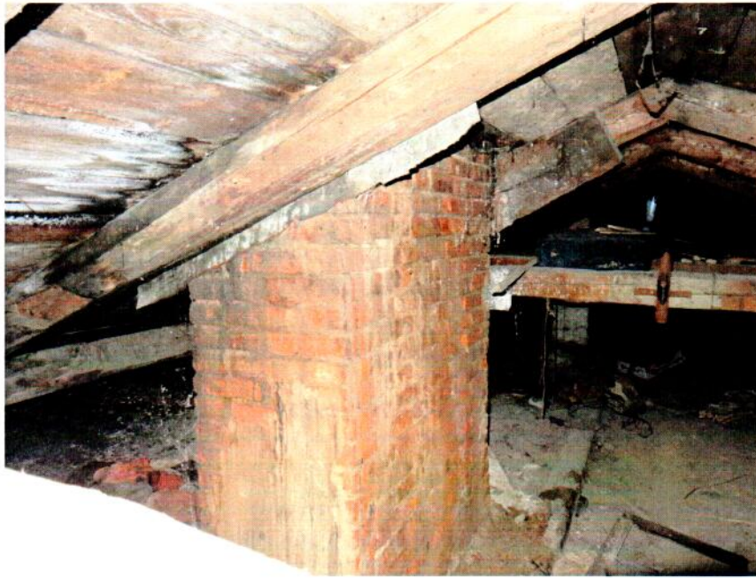
31. zagrzybiony fragment więźby dachowej
