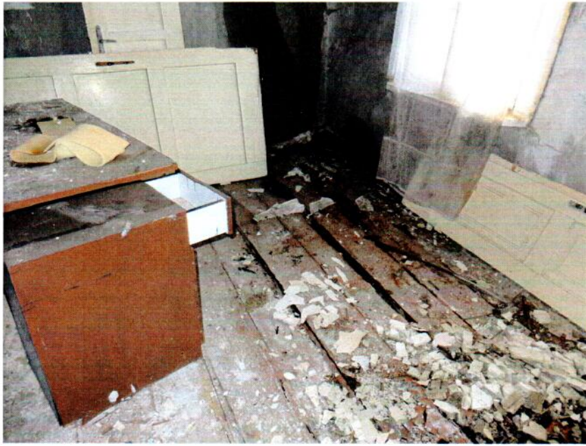
31. Stan desek podłogi w pomieszczeniu mieszkalnym
