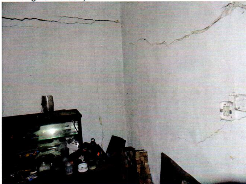
16. Ścianki działowe ceglane (spękania ściany i tynku spowodowane osiadaniem podłoża).
