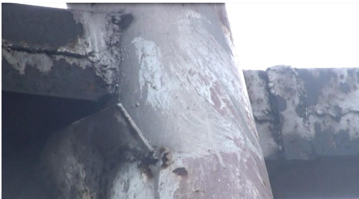
Fot. 23. Korozja powierzchniowa ceowników usztywniających i typowy węzeł z niską jakością spoin pachwinowych
