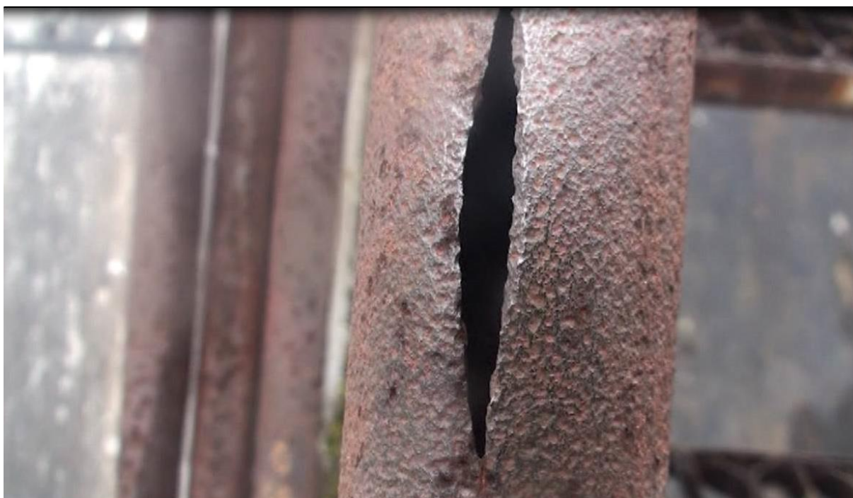
Fot. 16. Pęknięta rura barierki schodów przy zejściu z chodnika i widocznymi ubytkami korozyjnymi stali
