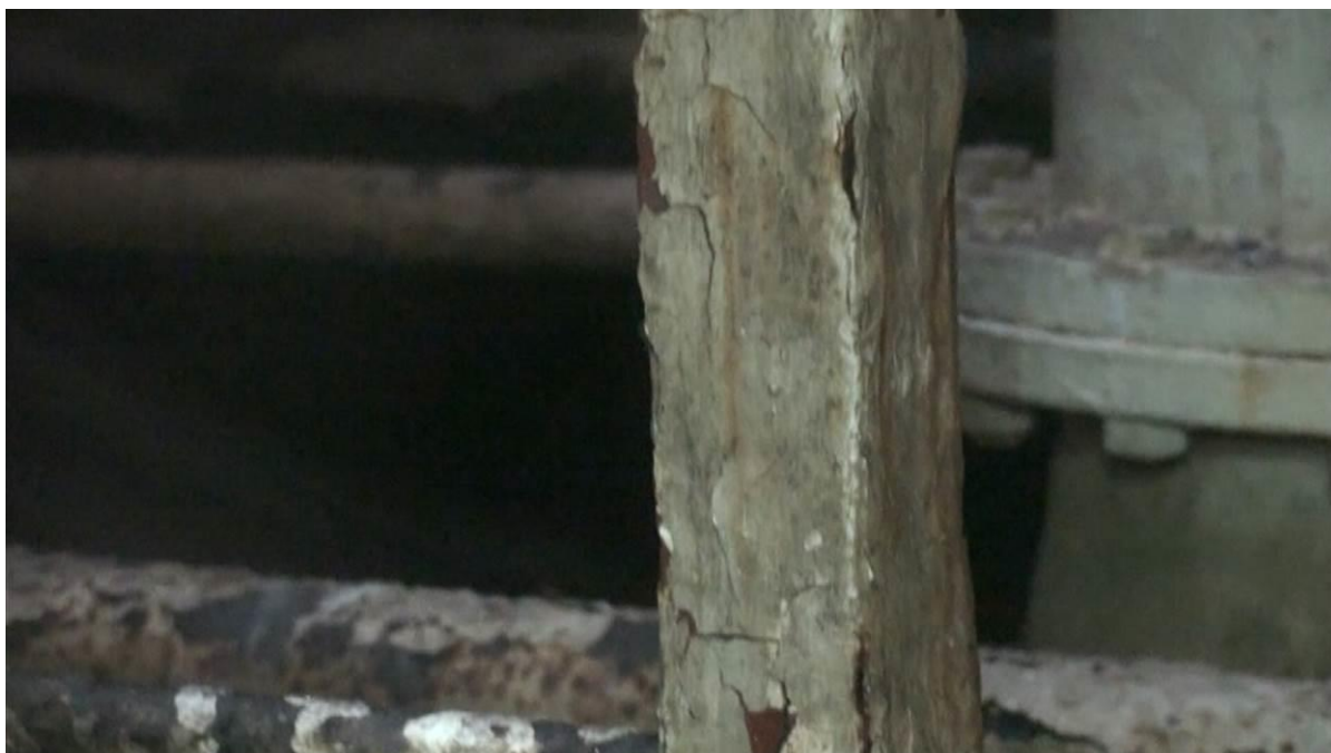
Fot. 4. Zniszczona, spękana i odspojona powłoka malarska ze śladami korozji podpowłokowej stali uchwyty drabinki włazowej wewnątrz zbiornika
