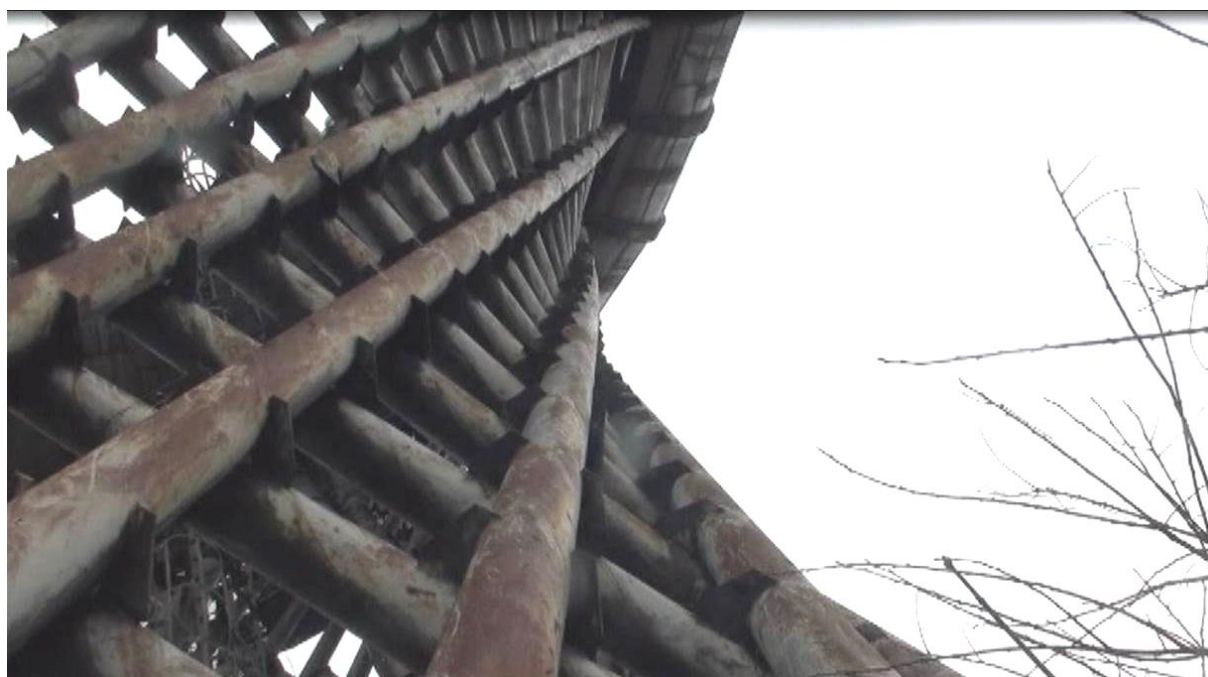
Fot. 32. Rury tworzące dwie powłoki hiperboloidalne nie mają osiowości (są zakrzywione)
