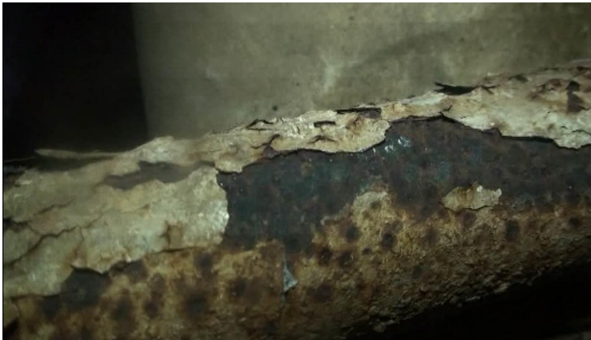
Fot. 3. Zniszczona powłoka malarska, równomierna korozja powierzchniowa i ogniska korozji wżerowej na usztywnieniu poziomym powłoki zbiornika od strony wewnętrznej
