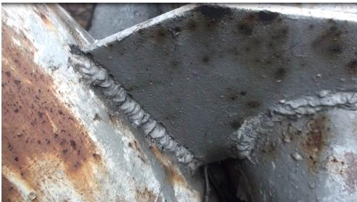
Fot.29, 30. Stan węzłów spawanych z na ogół bardzo niską jakością spoin
