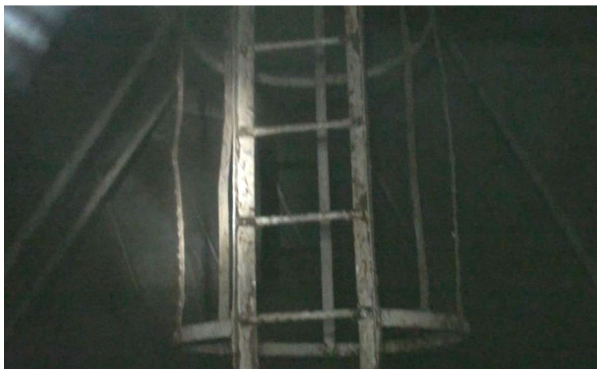
Fot. 8. Uszkodzenia powłok malarskich drabiny włazowej od strony wewnętrznej zbiornika
