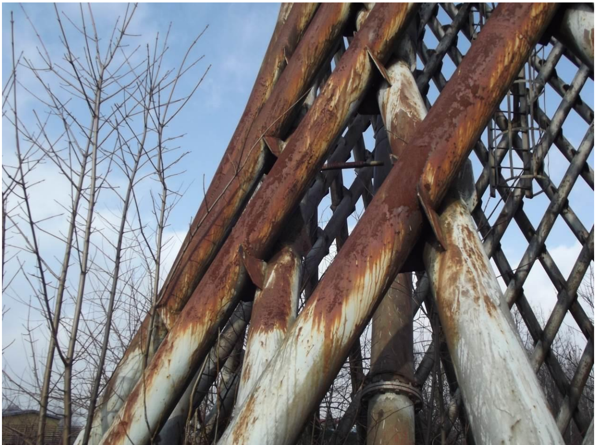
Fot. 35, 36. Główna fundamentu pierścieniowego i korozja atmosferyczna rur nośnych
