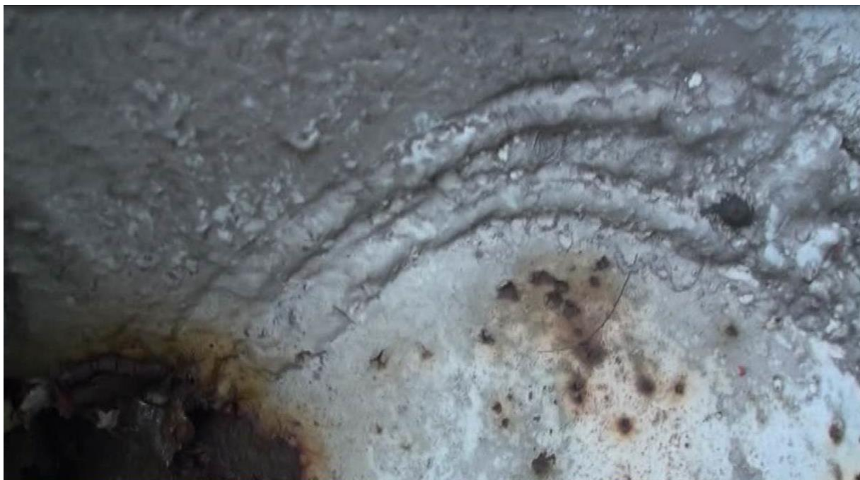
Fot. 31. Korozja miejscowa i niska jakość spoin blach węzłowych
