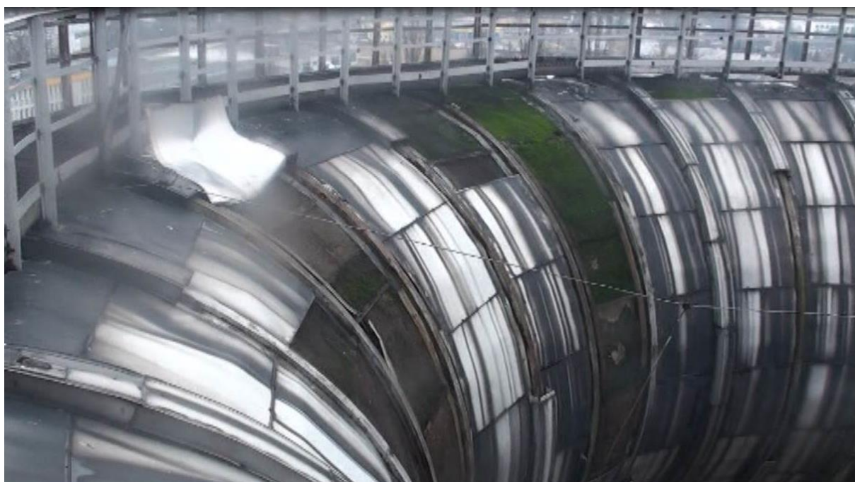
Fot. 11, 12. Stan blach osłonowych izolacji termicznej zbiornika wyrównawczego
