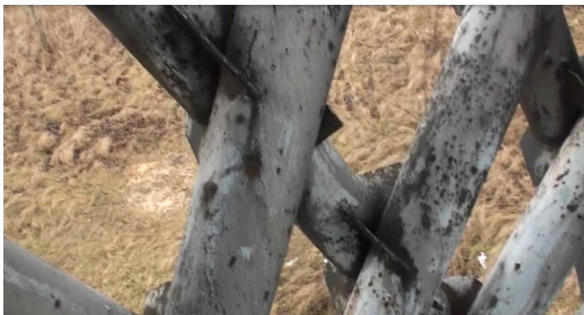
Fot. 24. Rury w węzłach łączone są za pomocą 4 blach węzłowych mocowanych spoinami pachwinowymi
