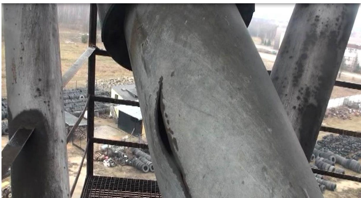
Fot. 22. Pęknięta rura dopływowa \varnothing 300 widoczna z poziomu galerii (ok. 1,5m poniżej pierścienia górnego)
