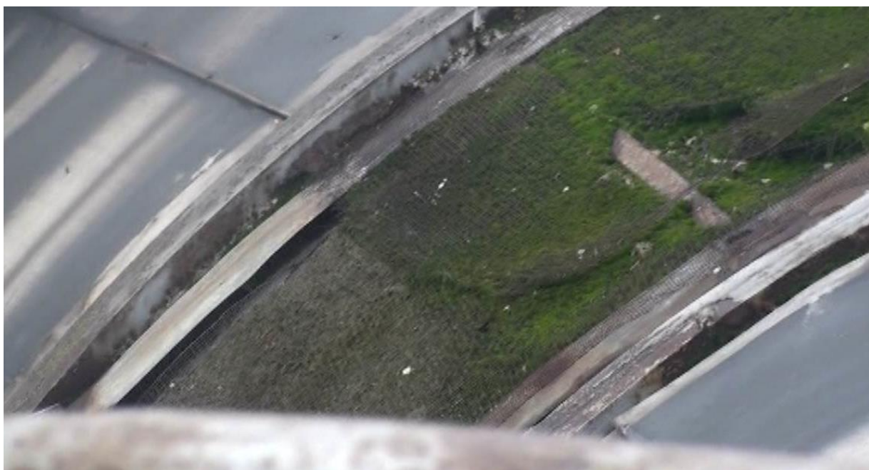
Fot. 10. Zerwane blachy osłonowe izolacji termicznej i widoczną warstwę warty szklanej
