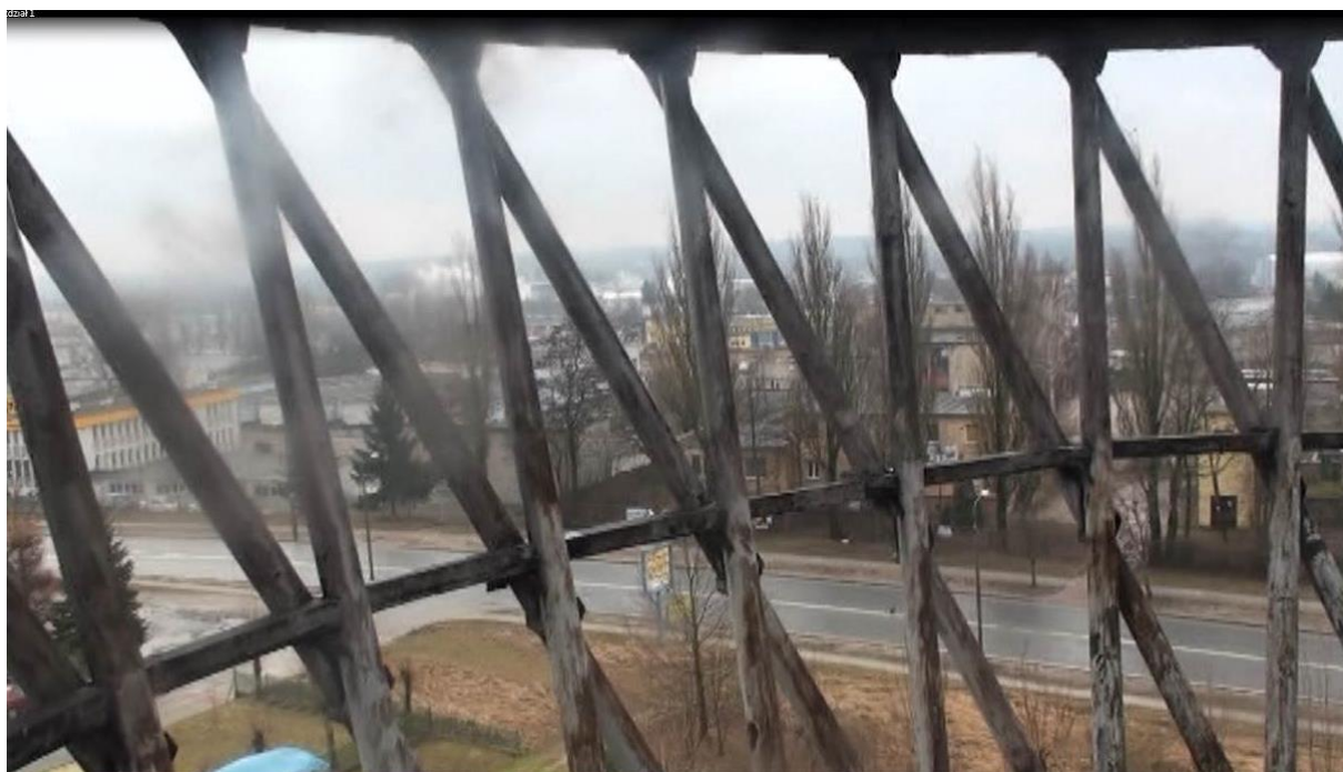
Fot. 19, 20. Stan konstrukcji wsporczej między pierścieniem górnym i usztywnieniem w poziomie +19,079m
