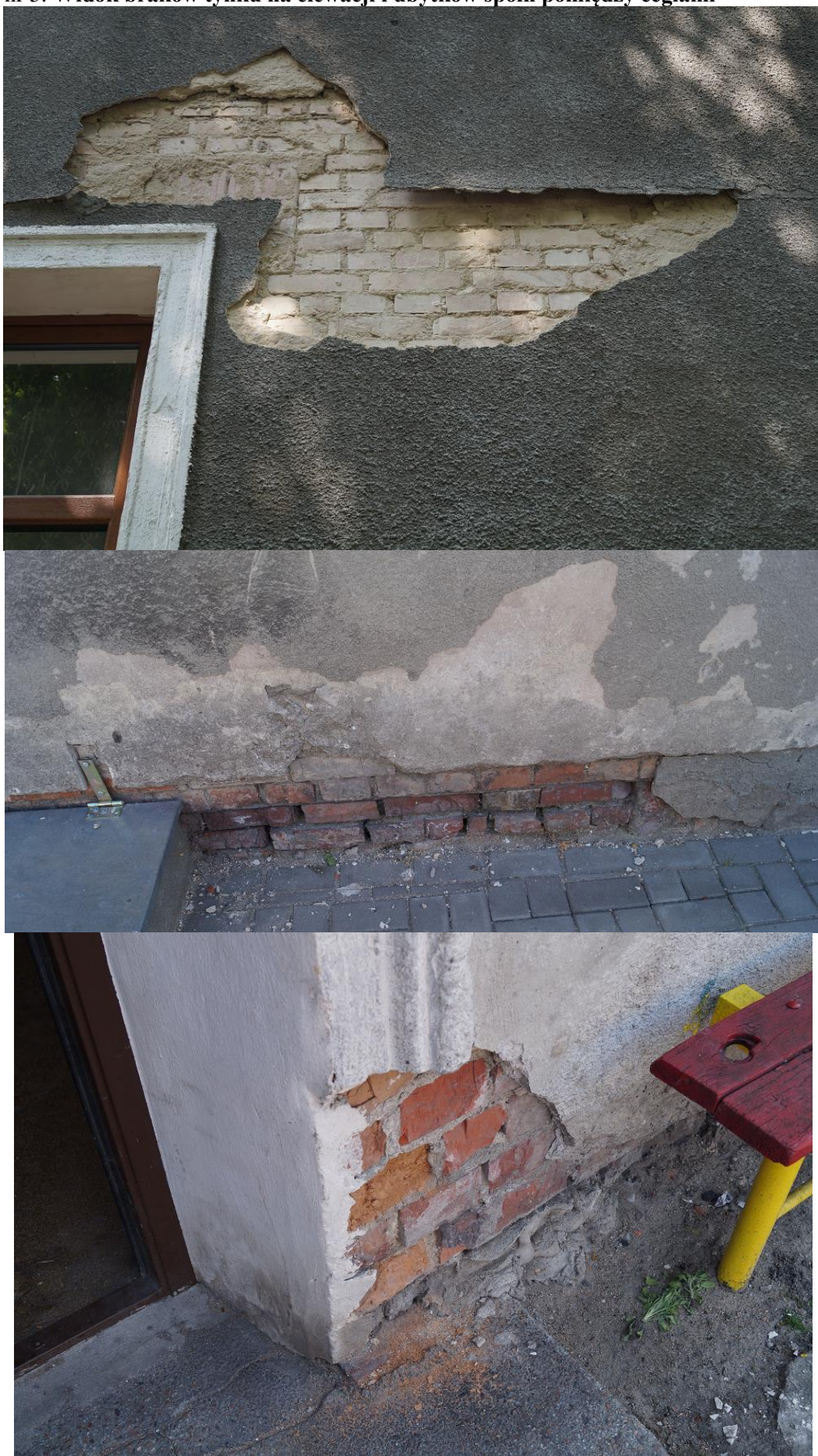
Rys. nr 5. Widok braków tynku na elewacji i ubytków spoin pomiędzy ceglami
