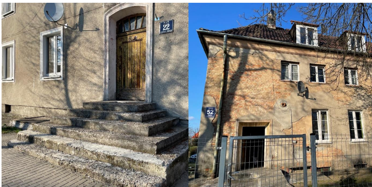
Zdjęcia 1 Stan budynków na osiedlu Bloki
