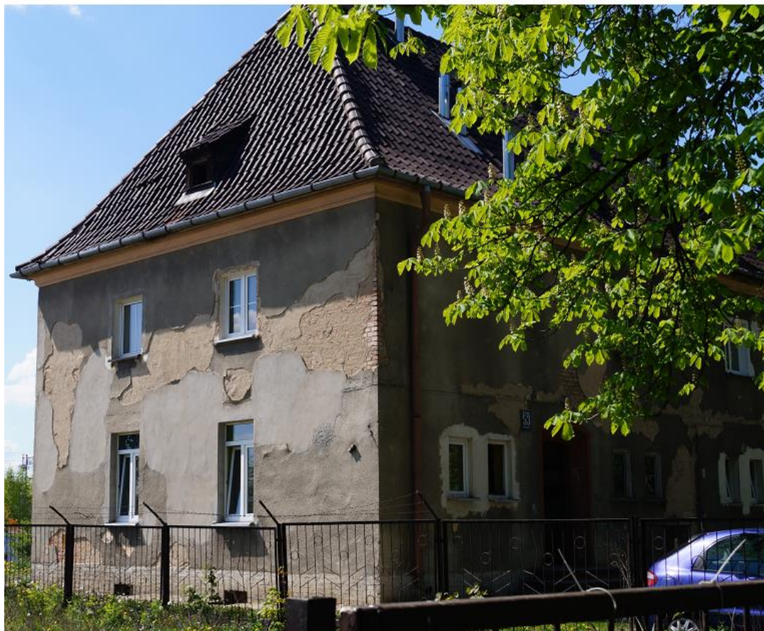
Rys. nr 4. Widok ubytków tynku na elewacji
