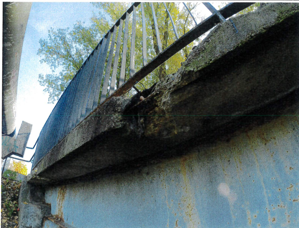
Fot. 3. Ubytki betonu gzymsu
