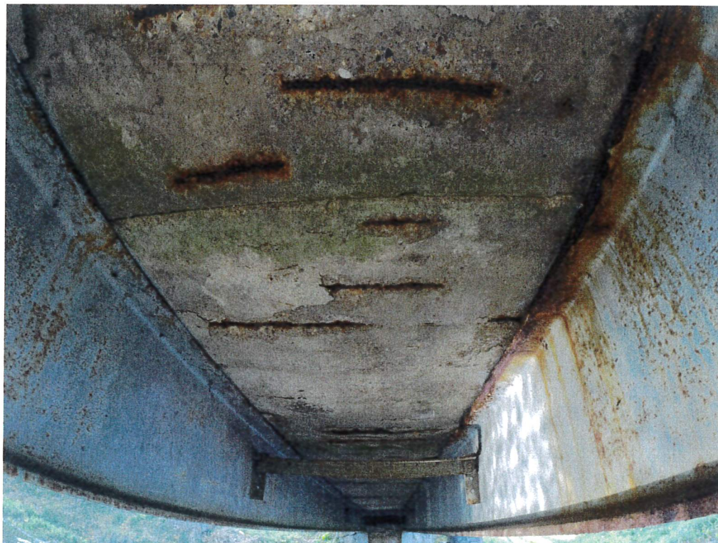
Fot. 4. Zwilgocenie, ubytki betonu, korozja zbrojenia w konstrukcji pomostu
