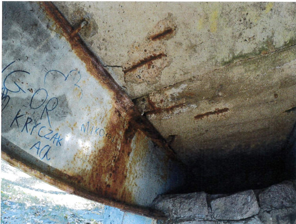
Fot. 2. Korozja jednego z dźwigarów głównych
