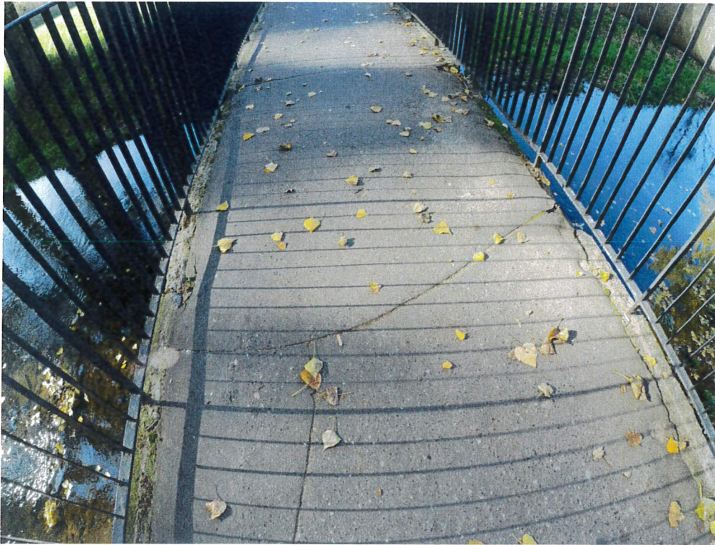
Fot. 1. Spękania nawierzchni chodnika
