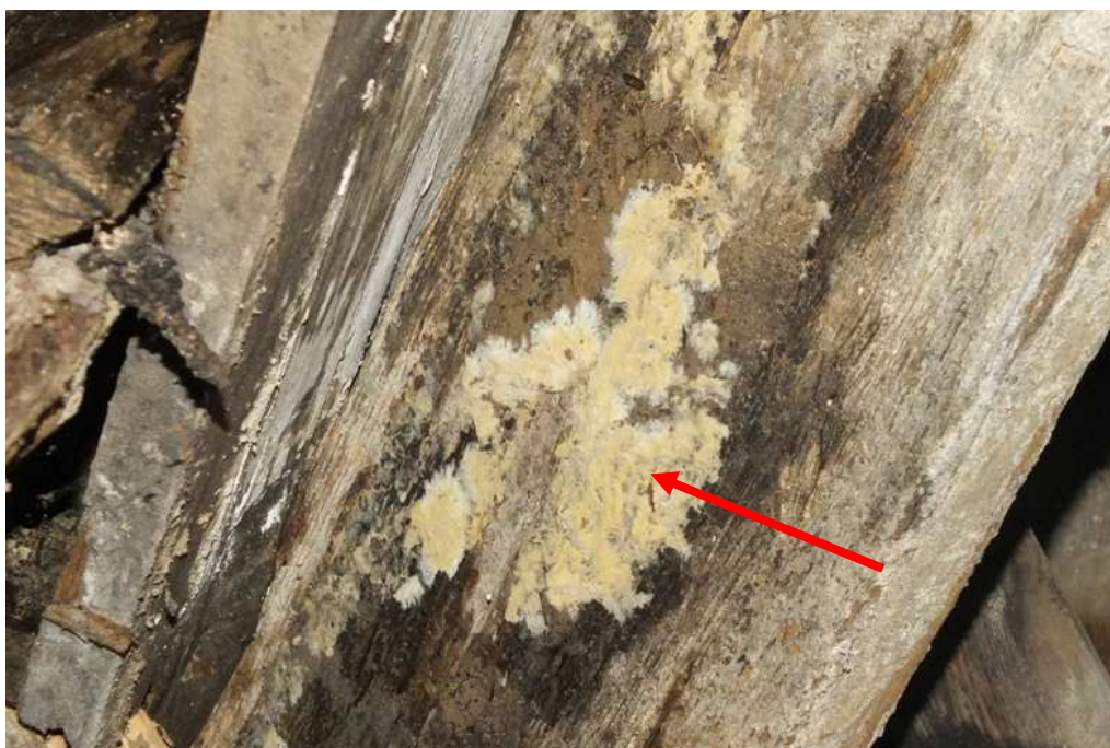
Fot. 36Pom.10. Elementy drewniane stropu porażone są przez . grzyba domowego Strocza domowego ( Serpula lacrymans ).
