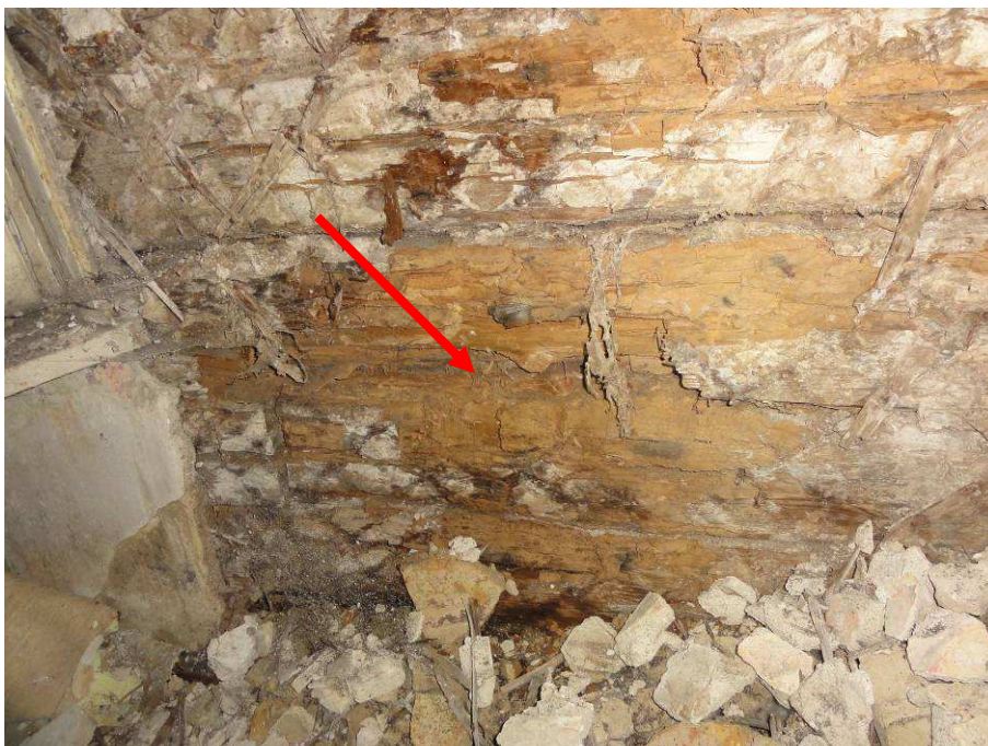
Fot. 24. Żły stan techniczny drewnianych brusów ściany działowej. Drewno osłabione i silnie porażone przez grzyba domowego właściwego.
