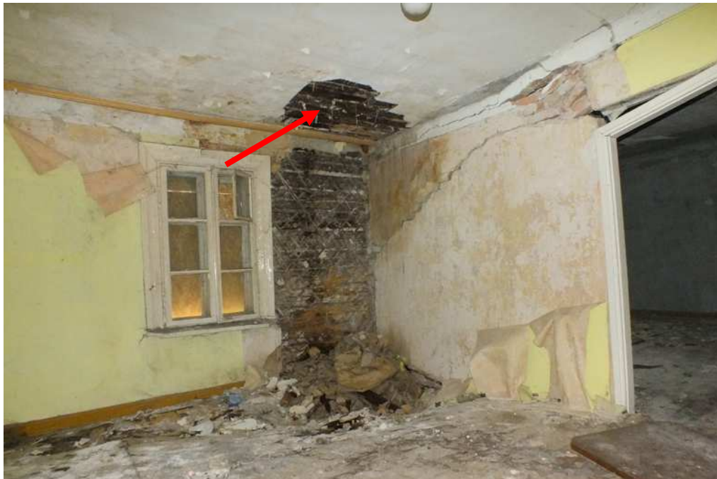
Fot. 16 Pom.1. Awaria zarówno warstw podłogowych ścian działowych oraz stropu spowodowana przenikaniem wód opadowych przez nieszczelności w dachu . Silna korozja biologiczna drewnianych brusów ściany.
