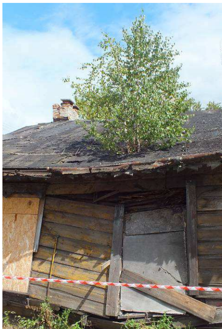
Fot. 4 Elewacja zachodnia. W miejscu gdzie poszycie dachowe uległo awarii rozwija się brzoza. Ma to katastrofalny wpływ na stan techniczny obiektu. Ściana w stanie awaryjnym.
