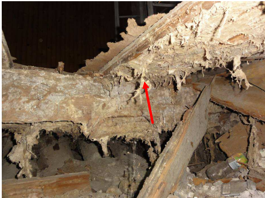
Fot. 34. Strefa podposadzkowa w pom. 1. Widoczne sznury grzyba domowego Stroczka domowego ( Serpula lacrymans ). Posadzka w złym stanie technicznym.
