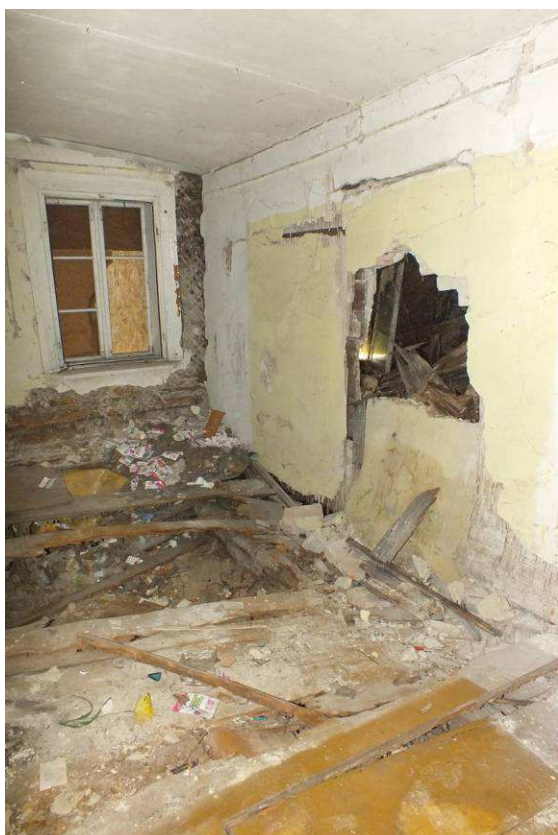
Fot. 15 Pom.1. Awaria zarówno warstw podłogowych ścian działowych. Silna korozja biologiczna drewnianych brusów ściany.
