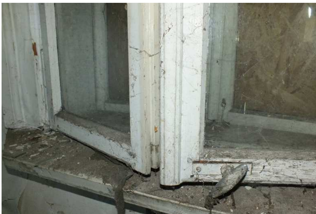
Fot. 47 Zły stan stolarki okiennej.
