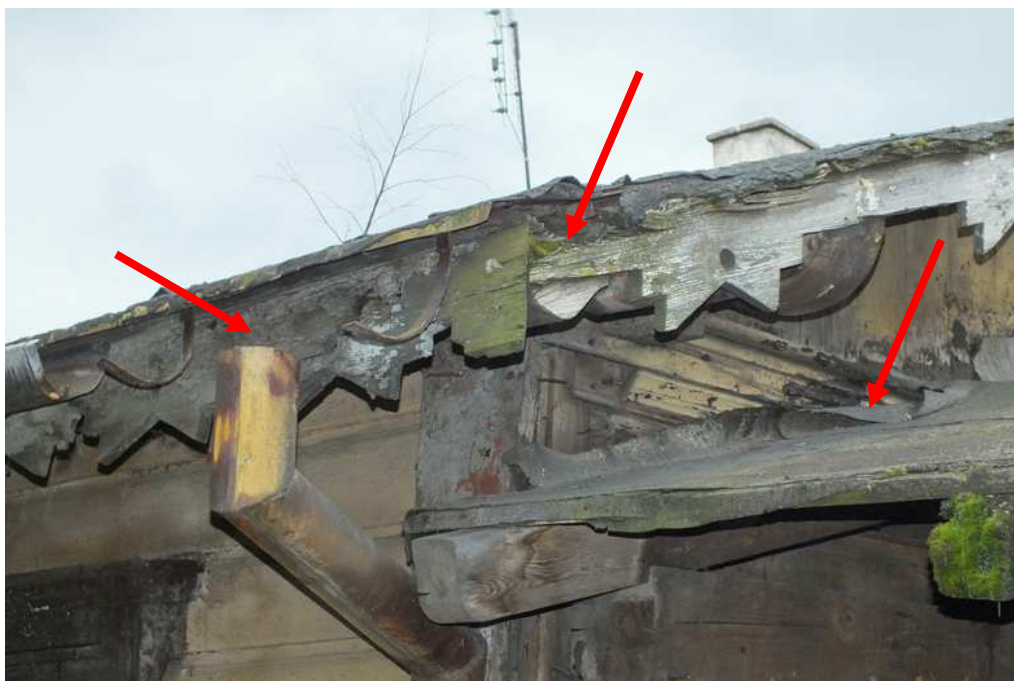
Fot. 12 Elewacja wschodnia. Zły stan systemu odprowadzenia wody deszczowej. Widoczna jest korozja detalu drewnianego oraz rozwój mchów świadczący o podwyższonej wilgotności w tej strefie. Źle wykonano obróbki łączące dach przybudówki ze ścianą budynku.
