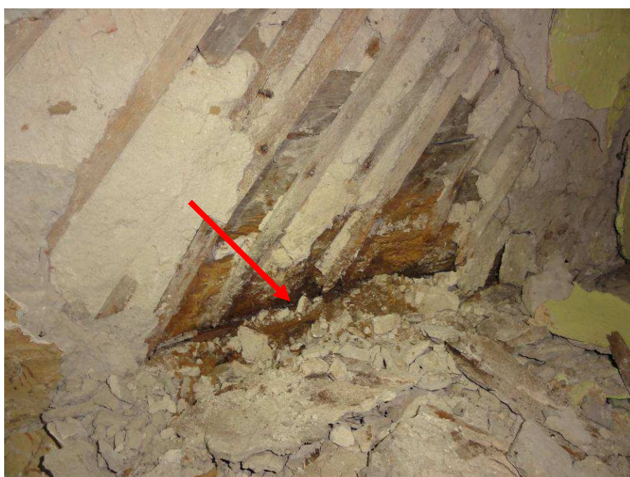
Fot. 22 Pom.3. Widoczna destrukcja elementów drewnianych (brusów) ścian zewnętrznych w wyniku szkodliwego działania grzybów domowych.
