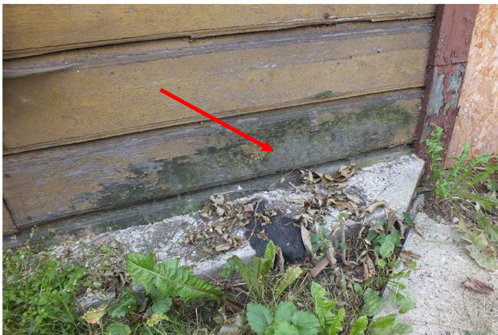
Fot. 7 Elewacja wschodnia. Betonowa opaska przy strefie fundamentu zawilgacanie dolnej strefy ścian. Na deskach szalowania ściany widoczny rozwój glonów co świadczy o częstym zawilgoceniu tej strefy.
