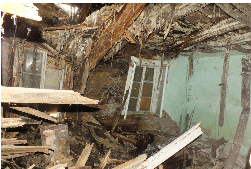
Fot. 17 Pom.10. Przeciek w poszyciu dachowym doprowadził do porażenia elementów drewnianych przez grzyby domowe. Elementy drewniane ścian dachu stropu oraz posadzki uległy destrukcji. Stan awaryjny grożący katastrofą budowlaną.
