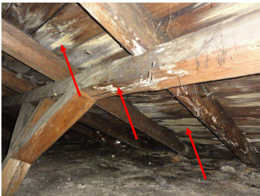
Fot. 41 W miejscach zawilgoceń konstrukcji dachu oraz na wielu deska poszycia dachowego widoczny rozwój grzyba domowego białego .
