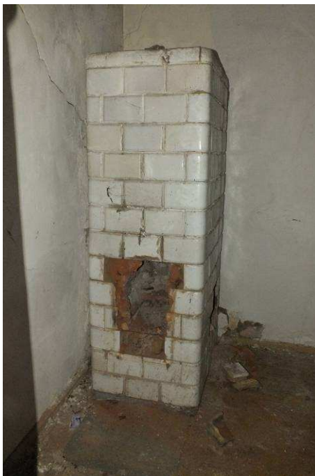
Fot. 44 Zniszczony piec kaflowy.
