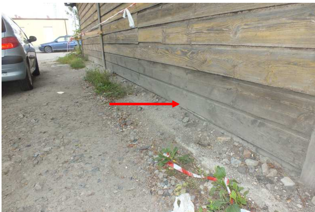
Fot. 6 Elewacja północna. Betonowa opaska przy strefie fundamentu oraz bliskość drogi dojazdowej w dni deszczowe powoduje zawilgacanie dolnej strefy ścian .
