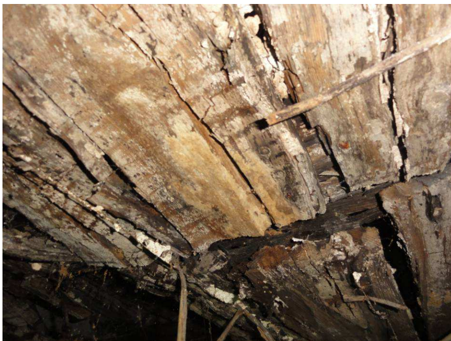
Fot. 37 Pom.8. Elementy drewniane stropu porażone są przez . grzyba domowego Strocza domowego ( Serpula lacrymans ). Stan techniczny stropu grozi zawaleniem.
