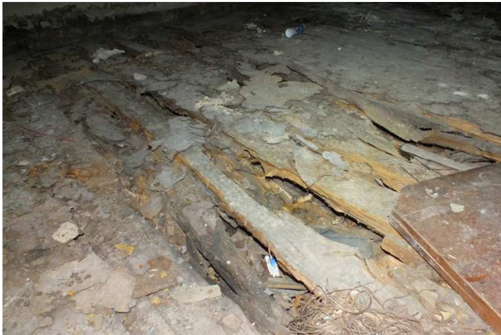
Fot. 30. Pom. 8. Zły stan techniczny posadzek drewnianych wywołany szkodliwym działaniem grzyba domowego Strocza domowego ( Serpula lacrymans ).
