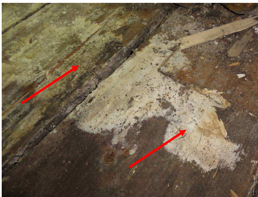
Fot. 31. Rozwój grzyba domowego Strocza domowego ( Serpula lacrymans ) na drewnianej posadzce.
