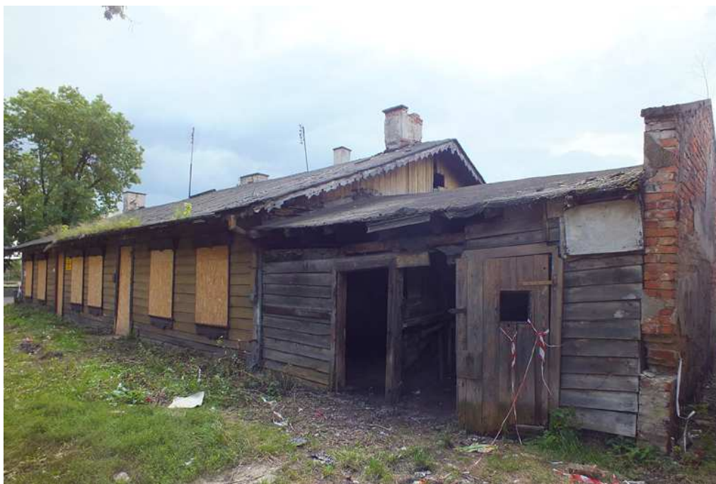
Fot. 3 Elewacja wschodnia. Drewniana dobudówka w złym stanie technicznym.
