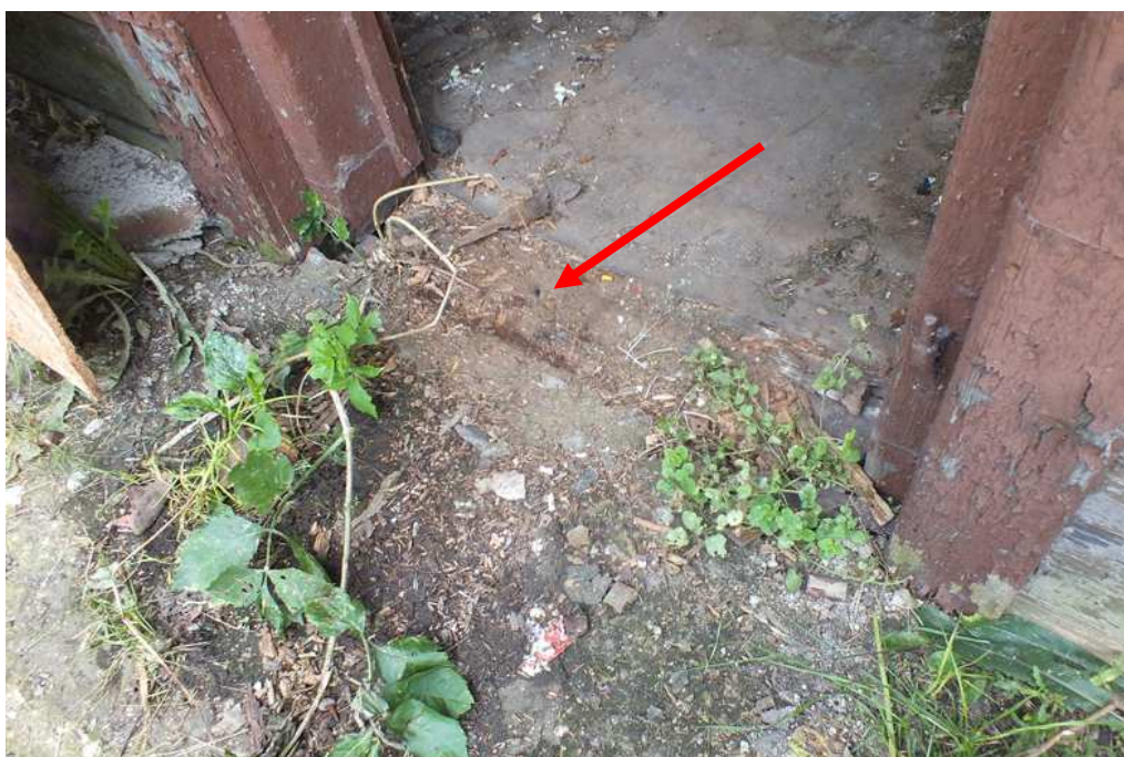
Fot. 10 Elewacja wschodnia. Brak odpowiedniego zabezpieczenia progu drzwiowego doprowadził do jego zniszczenia. Widoczny rozkład drewna spowodowany działaniem grzyba domowego.
