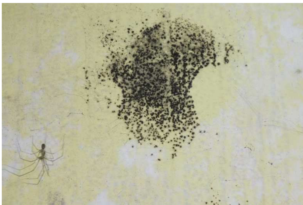
Fot. 19 Pom.6. W miejscach kondensacji pary wodnej zawartej w powietrzu widoczny rozwój grzybów pleśniowych.
