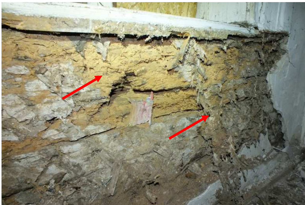
Fot. 19 Pom.6. Widoczna destrukcja elementów drewnianych (brusów) ścian zewnętrznych w wyniku porażenia ich przez owady Spuszczel pospolity ( Hylotrupes bajulus ) oraz przez grzyba domowego właściwego.
