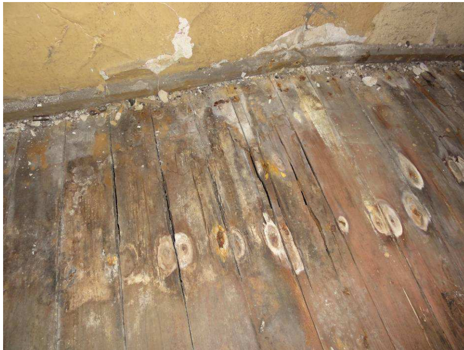
Fot. 28. Pom. 7. Zły stan techniczny posadzek drewnianych wywołany szkodliwym działaniem grzyba domowego Strocza domowego ( Serpula lacrymans ).
