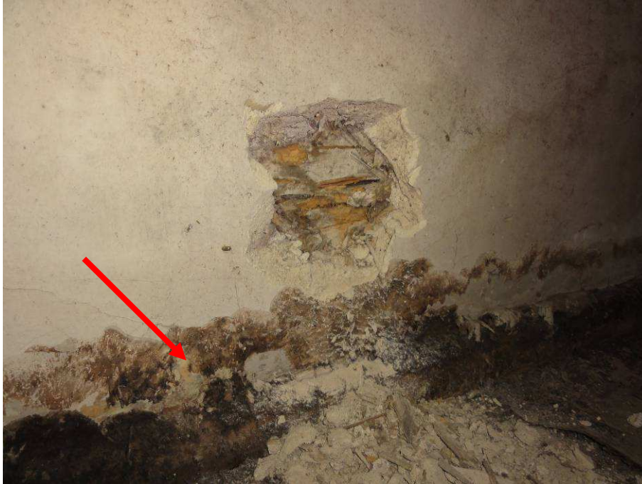
Fot. 23 Pom.1. Strefa porażenia ścian przez grzyba domowego piwnicznego.
