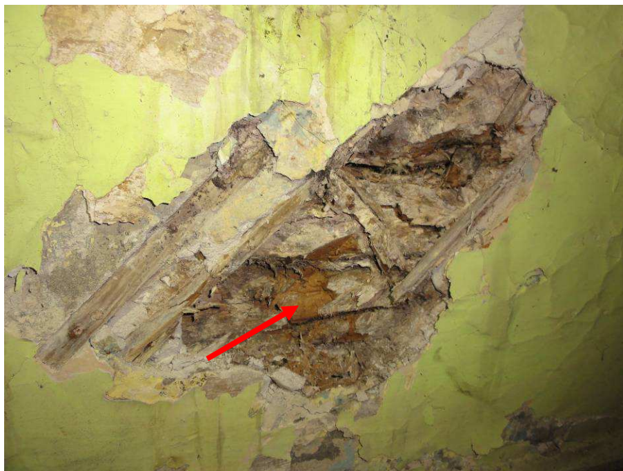
Fot. 21 Pom.3. Odkrywka. Widoczna destrukcja elementów drewnianych (brusów) ścian zewnętrznych w wyniku porażenia ich przez grzyby domowe.
