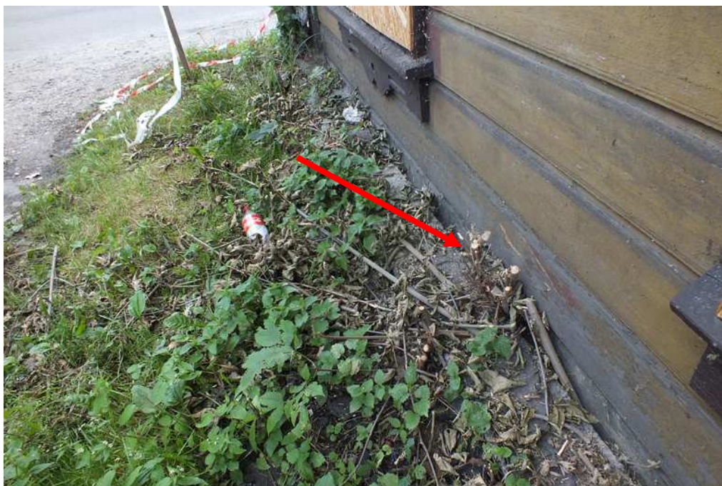
Fot. 8 Elewacja wschodnia. Betonowa opaska przy strefie fundamentu zawilgacanie dolnej strefy ścian. Rośliny rosnące na styku ściany i betonowej opaski doprowadziły to utworzenia się szczeliny przez którą wnika wilgoć w strefę podwaliny i fundamentu.
