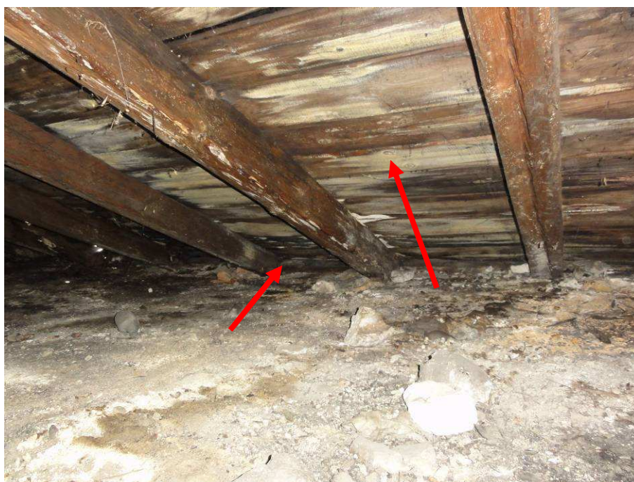
Fot. 40 W miejscach zawilgoceń konstrukcji dachu oraz na wielu deskach poszycia dachowego widoczny rozwój grzyba domowego.
