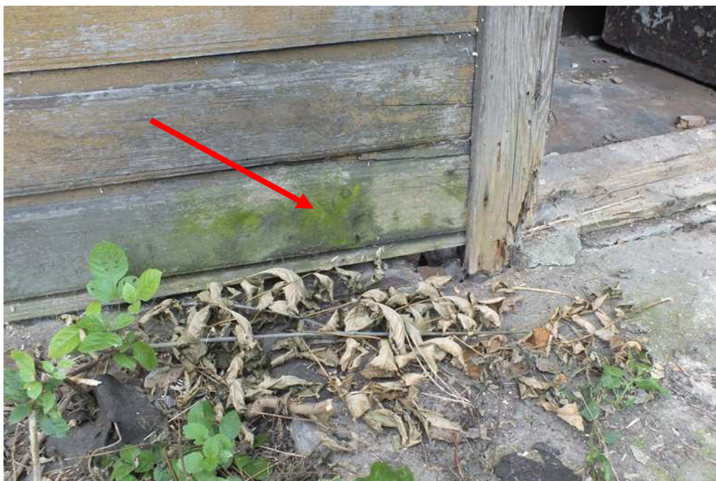
Fot. 9 Elewacja wschodnia. Betonowa opaska przy strefie fundamentu powoduje zawilgacanie dolnej strefy ścian. Na deskach szalowania ściany widoczny rozwój glonów co świadczy o częstym zawilgoceniu tej strefy.
