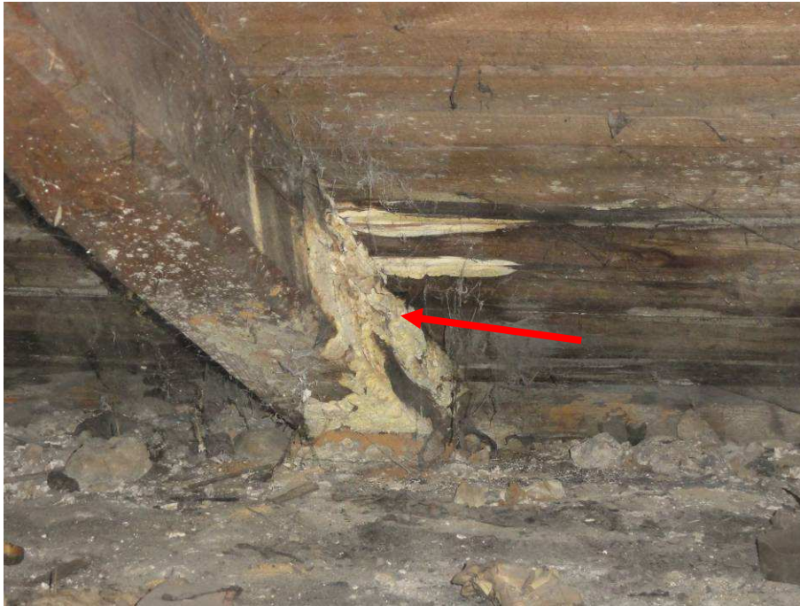
Fot. 43 W miejscach zawilgoceń konstrukcji dachu widoczny rozwój grzyba domowego białego.
