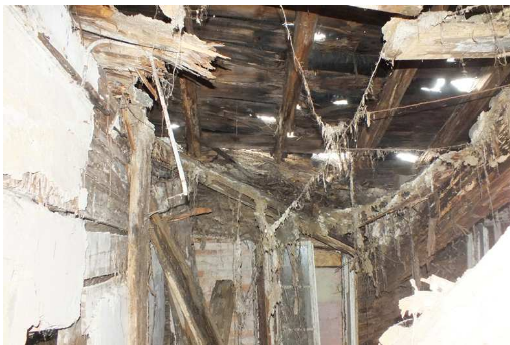
Fot. 35 Pom.10. Przeciek w poszyciu dachowym doprowadził do porażenia elementów drewnianych przez grzyby domowe. Elementy drewniane ścian dachu stropu oraz posadzki uległy destrukcji. Stan awaryjny grożący katastrofą budowlaną.
