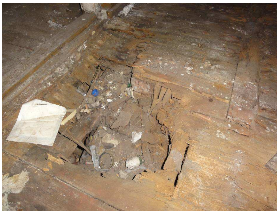
Fot. 29. Pom. 7. Zły stan techniczny posadzek drewnianych wywołany szkodliwym działaniem grzyba domowego Strocza domowego ( Serpula lacrymans ).
