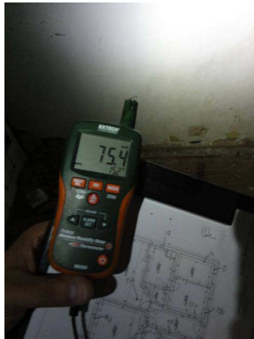
Fot. 45 Wysoka wilgotność powietrza w pomieszczeniach.
