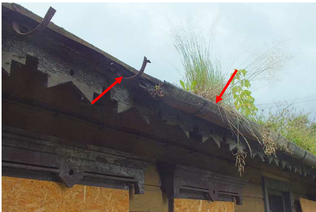
Fot. 11 Elewacja wschodnia. Zły stan systemu odprowadzenia wody deszczowej. Miejscowy brak elementów rynnowych oraz rosnąca w nich trawa powodują zawilgacanie drewnianych elementów dachu oraz ścian.
