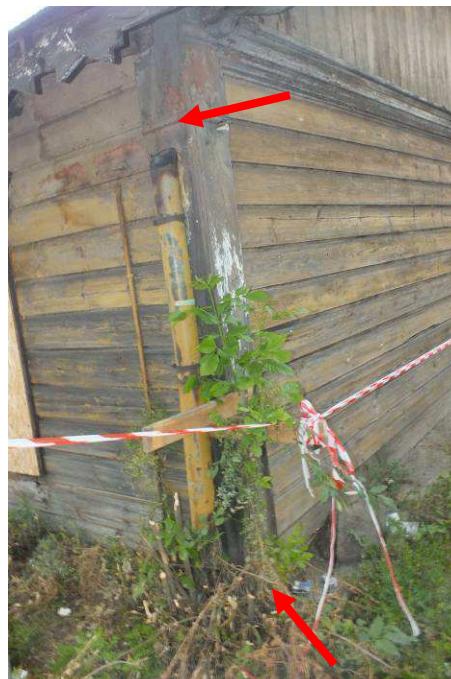
Fot. 5 Elewacja zachodnia/północna. Zły stan techniczny systemu odprowadzenia wody deszczowej oraz obecność roślinności w strefie fundamentu ma negatywny wpływ na stan techniczny obiektu.
