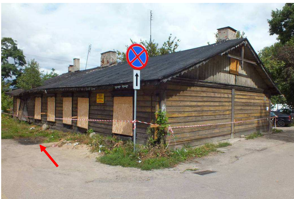
Fot. 2 Elewacja północna i zachodnia. Na zdjęciu widoczne jest miejsce gdzie tworzy się niecka wodna.
