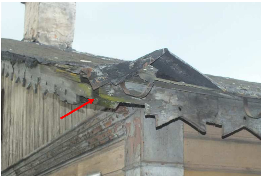
Fot. 13 Elewacja wschodnia. Zły stan systemu odprowadzenia wody deszczowej doprowadził do zniszczenia drewnianych detali w budynku. Występowanie glonów świadczy o częstym zawilgoceniu drewna w tej strefie.
