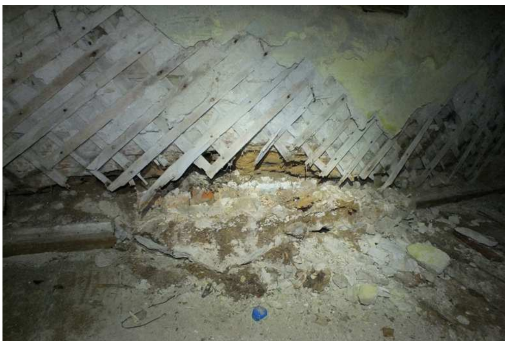
Fot. 20 Pom.3. Widoczna destrukcja elementów drewnianych (brusów) ścian zewnętrznych w wyniku porażenia ich przez szkodliwe działanie grzybów domowych.
