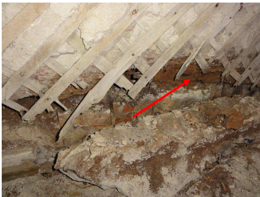
Fot. 26. Pom. 3. Zły stan techniczny ścian na połączeniu z posadzką wywołany szkodliwym działaniem grzyba domowego Stroczka domowego ( Serpula lacrymans ). Widoczny brunatny rozkład drewnianej konstrukcji ściany
