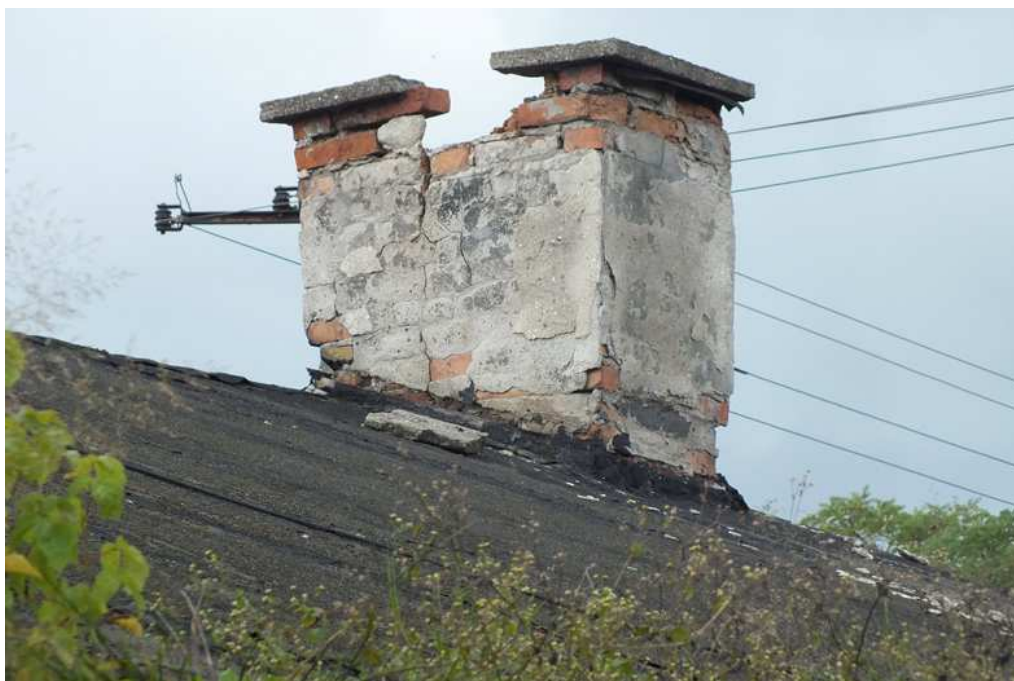
Fot. 14 Zły stan murowanych kominów. Struktura muru jest silnie spękana widoczne liczne ubytki.
