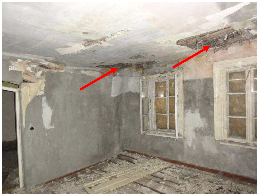
Fot. 18 Pom.2. Przekiek w poszyciu dachowym doprowadził do porażenia elementów drewnianych przez grzyby domowe. Elementy drewniane ścian dachu stropu oraz posadzki uległy destrukcji.
