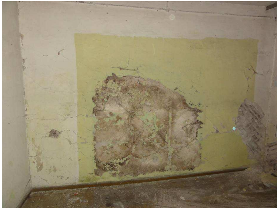
Fot. 24. Pom. 6 Na ścianie widoczny rozwój grzyba domowego Strocza domowego ( Serpula lacrymans )
