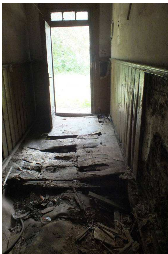
Fot. 15 Pom.9. Awaria zarówno warstw podłogowych ścian działowych. Silna korozja biologiczna drewnianych brusów ściany.
