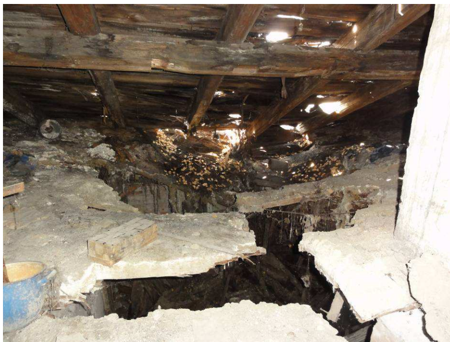
Fot. 38 Zły stan poszyci dachowego doprowadził do zalewania drewnianej konstrukcji przez wody opadowe co w konsekwencji doprowadziło do dużych zniszczeń elementów drewnianych porażonych przez grzyby domowe.
