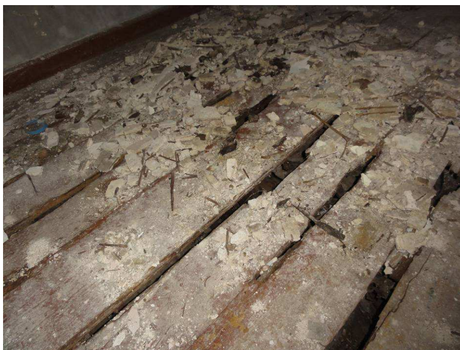
Fot. 27. Pom. 2. Zły stan techniczny posadzek drewnianych wywołany szkodliwym działaniem grzyba domowego Stroczka domowego ( Serpula lacrymans ).
